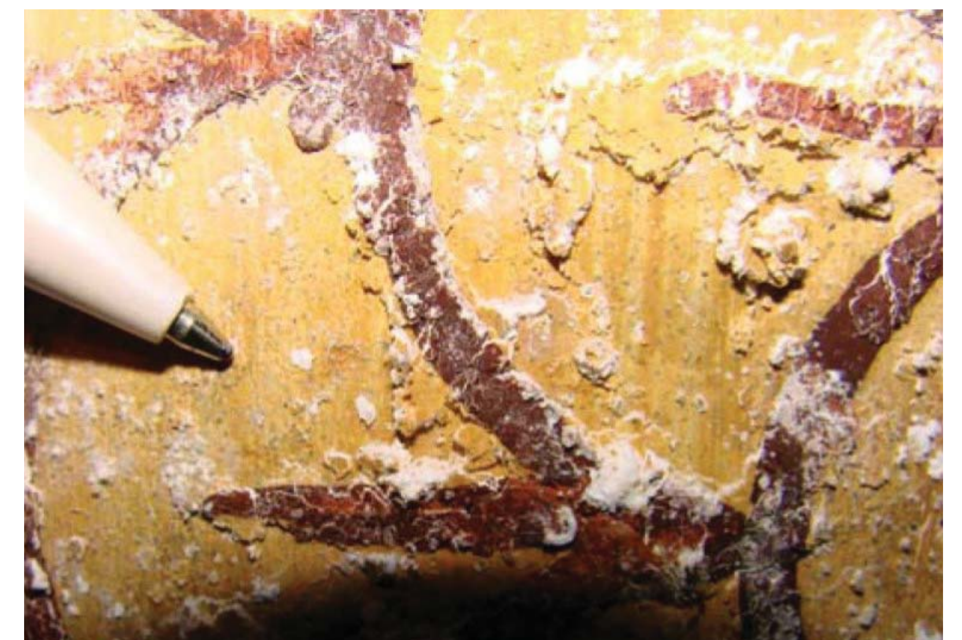
Fig. 3: Dettaglio dei sollevamenti di film pittorico, causati da efflorescenze saline di aspetto granuloso composte da epsomite. Cattedrale di San Lorenzo, Lugano. A. Küng, 2008.
