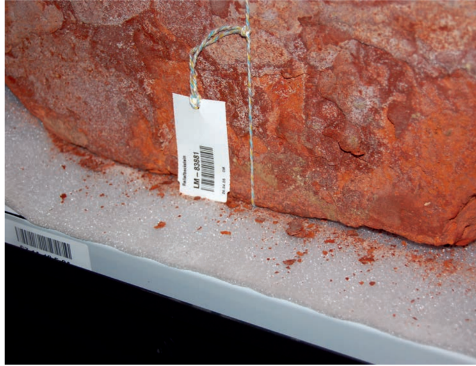
Die Schadensbilder Salzausblühungen, körniger Zerfall, Abschalen und Abschuppen an einem mittelalterlichen Reliefbackstein.
