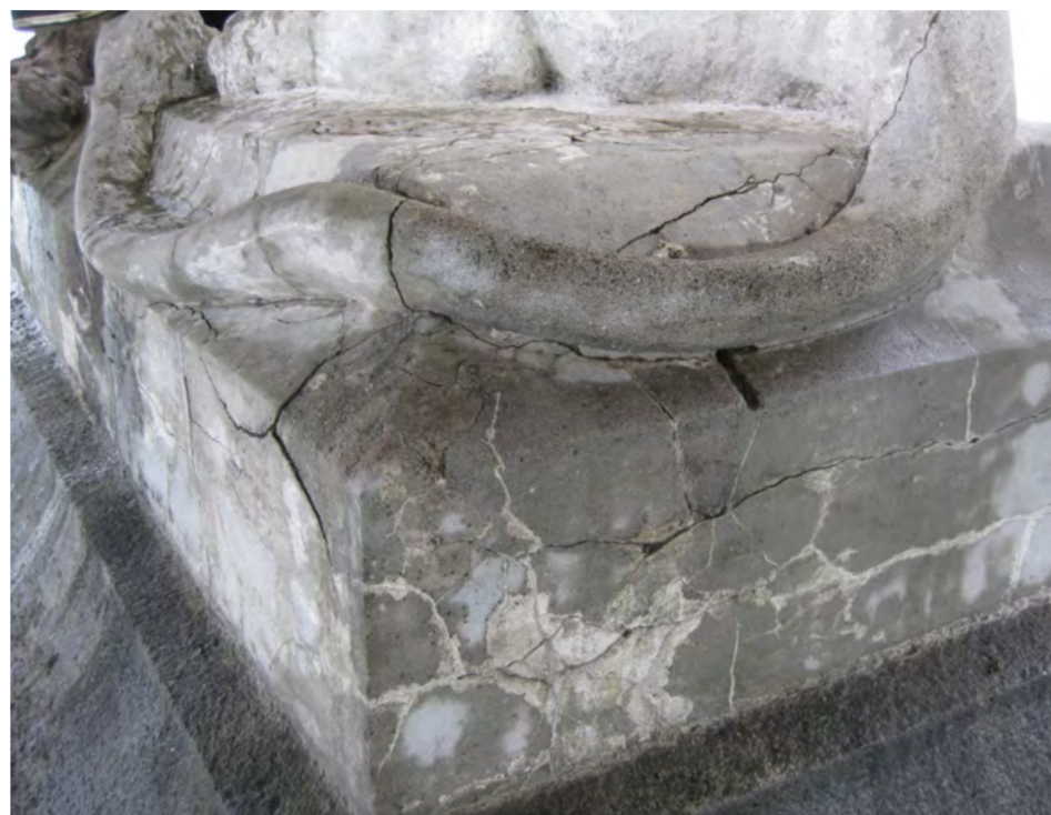
Detail Vorzustand, nach der Reinigung. Der stark zerrissene Schwanz- und Sockelbereich war kurz vor dem Abfallen.
